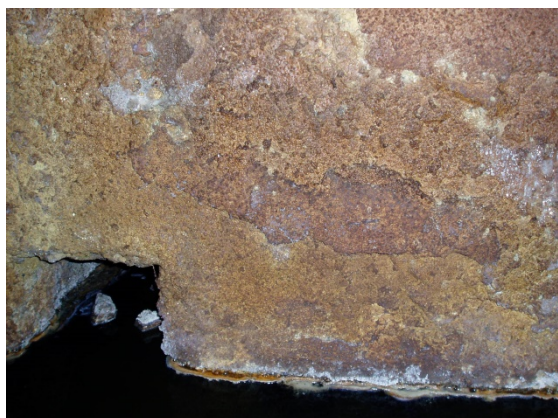
腐敗槽隔壁の腐食による劣化
